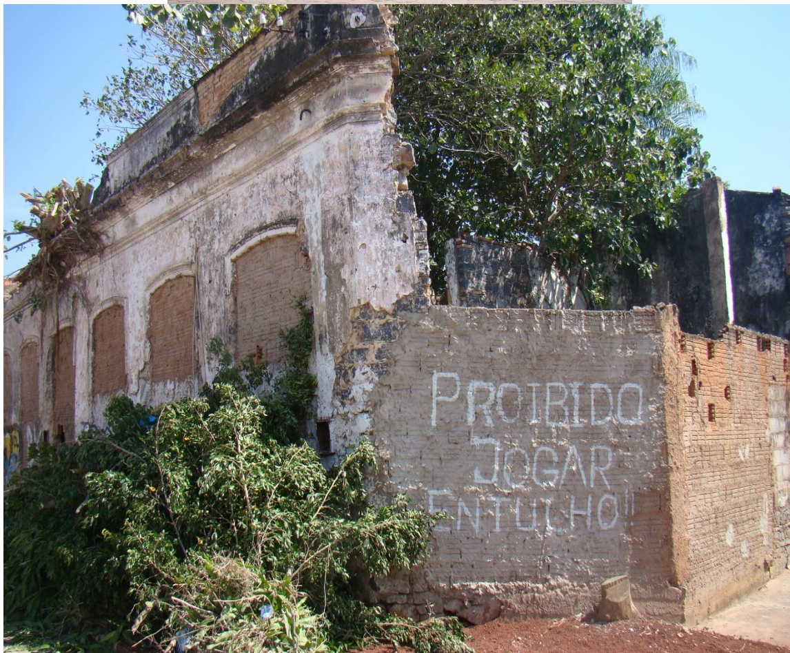
Prédio abandonado no último quarteirão da rua Delamare, área da antiga favela Sarobá (Fotos registradas em 15/08/2019)
