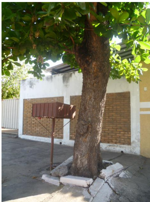
Figura 23: Sistema radicular superficial de sete copas ( Terminalia catappa ): causa levantamento e estragos na calçada e representa um risco aos transeuntes (Arquivo pessoal. 2013).
