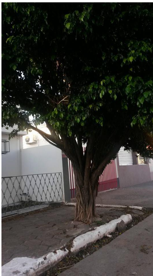
Figura 47: Arborização urbana de Corumbá, MS: árvore sem espaço livre em torno do colo. A pressão das raízes está causando o levantamento do passeio (Arquivo pessoal. 2014).
